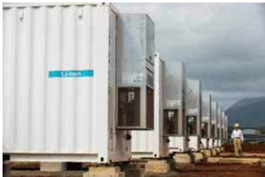
欧洲某能源集团节能测试规模应用
