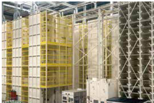
欧洲某大型电池企业节能测试规模应用
