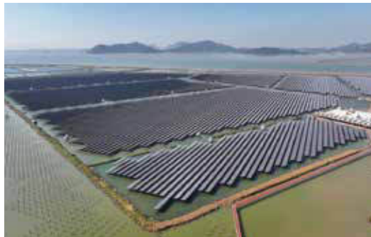
► 广东某能源集团储能项目
