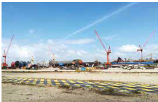
► 中东某地区建筑工地拖挂式临时电源解
