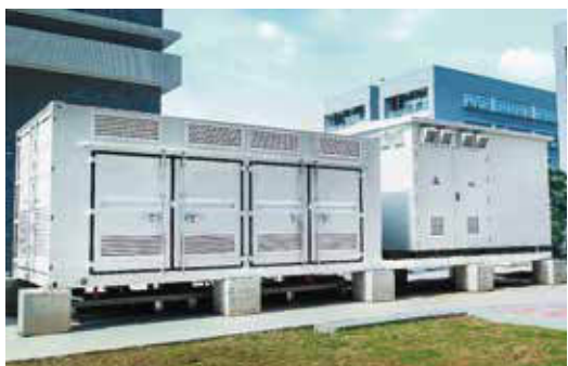
► 江苏盐城某综合国企储能项目
