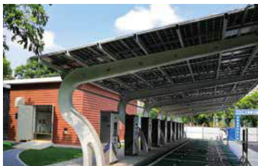
► 广东东莞某光储充检项目
